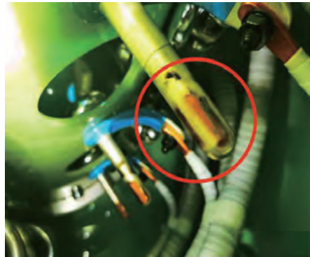
图3 分接开关选择器K+触头烧损痕迹
