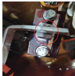
图3 接地刀闸处于合闸位置
