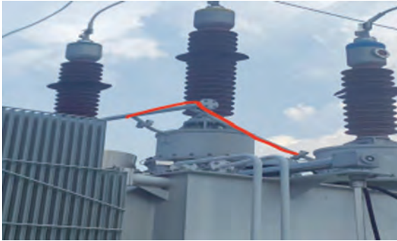
图2 变压器油管路安装缺陷现场照片
