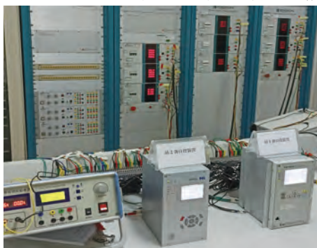
图5 远方备自投装置测试接线
