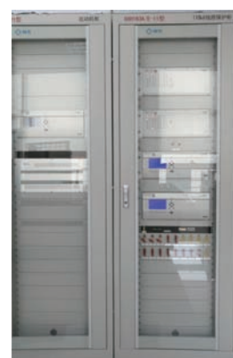
图3 智能变电站主要设备
