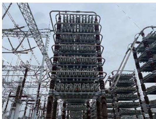
图1 滤波器电容器现场布置方式
