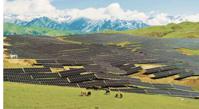
新疆中绿电尼勒克400万千瓦风电光伏一体化项目。中国绿发供图
